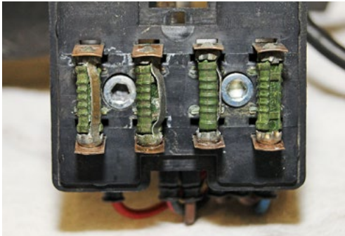
Hier kommt alles zusammen: falsche SICHERUNGEN , Durchschmorungen und Oxidation
