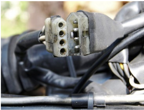
Einer der STECKKONTAKTE innerhalb des Multisteckers ist leicht verschmort. Der Schaden ist von außen nicht erkennbar
