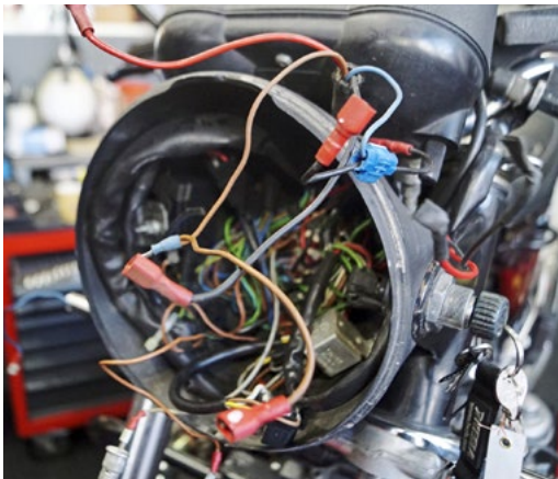
FALSCHER KABELFARBEN und Isolationen: Derlei Fehler dürfen beim Nachbau des Kabelbaums nicht übernommen werden
