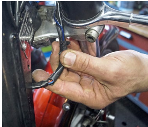
Hier wurde der Original-Kabelbaum am Lenkkopf falsch verlegt, sodass die ISOLATION GEQUETSCHT wurde
