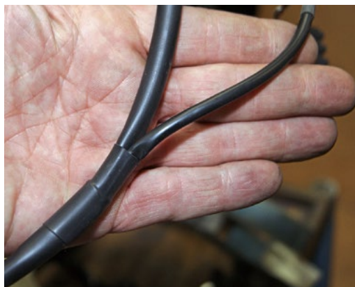
Schrumpfschläuche wurden meist nicht verwendet, schützen aber dauerhaft vor MECHANISCHEN BESCHÄDIGUNGEN
